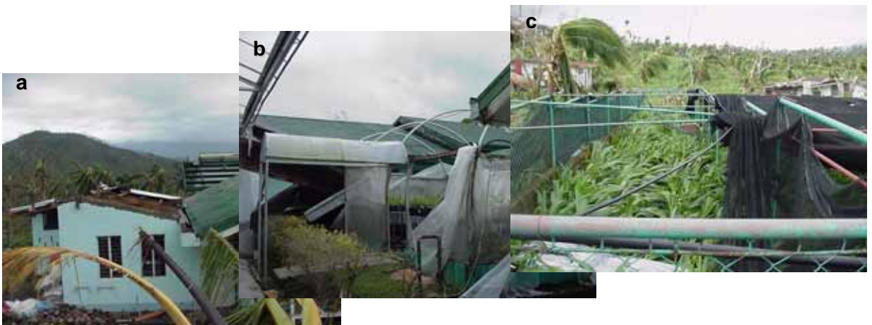
Gambar 17. Fasilitas kultur jaringan kelapa yang hancur oleh Topan Reming: a) bangunan laboratorium tambahan; b) rumah kaca / ruang dengan pengatur kelembaban; c) tempat pembibitan
